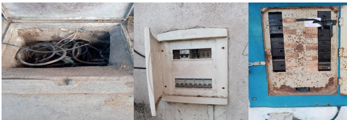
Figura 4 – Fotografias do atual sistema de proteção inadequado
