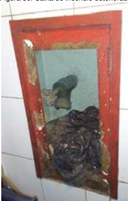
Figura 36: Caixa de incêndio deteriorada
