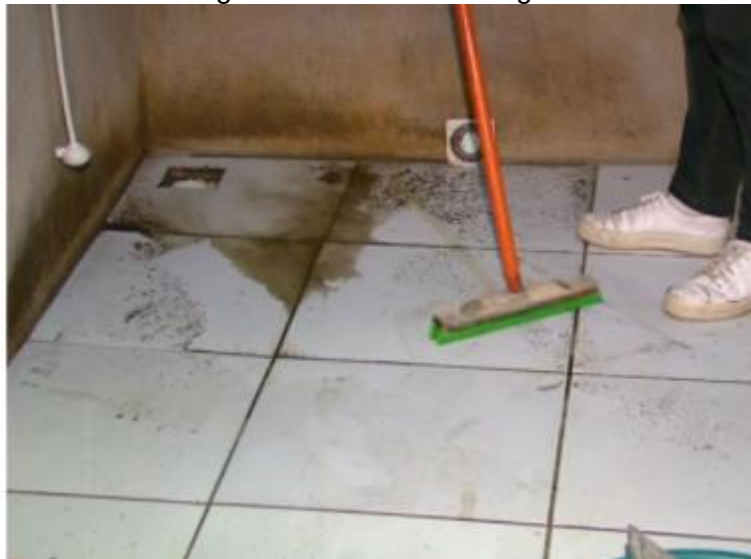
Figura 30: Retorno de esgoto
