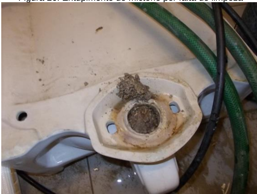
Figura 26: Entupimento do mictório por falta de limpeza
