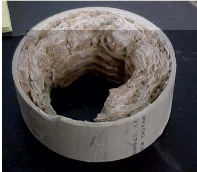
Figura 29: Entupimento de tubulação por incrustação
