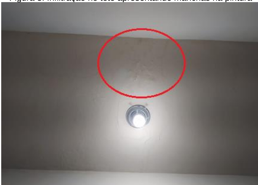
Figura 8: Infiltração no teto apresentando manchas na pintura
