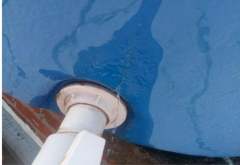
Figura 12: Rachadura em reservatório de fibra
