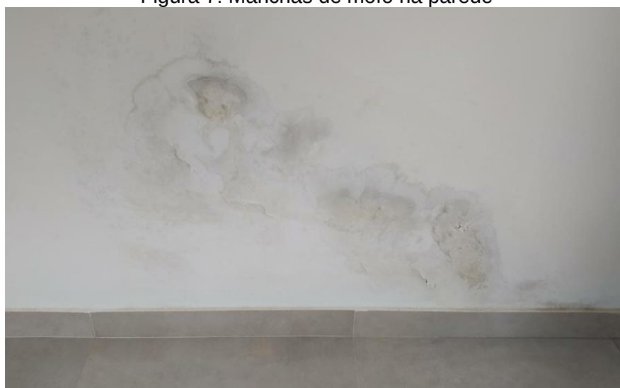
Figura 7: Manchas de mofo na parede
