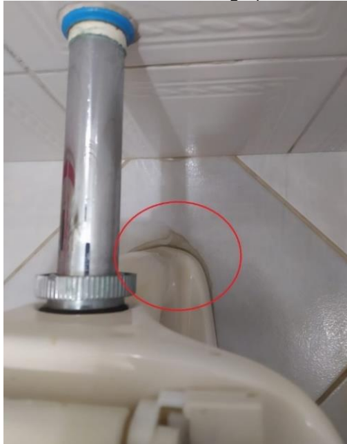
Figura 28: Vazamento no tubo de ligação do vaso sanitário
