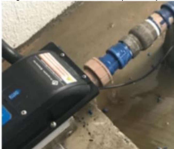
Figura 5: Vazamento na bomba de pressurização
