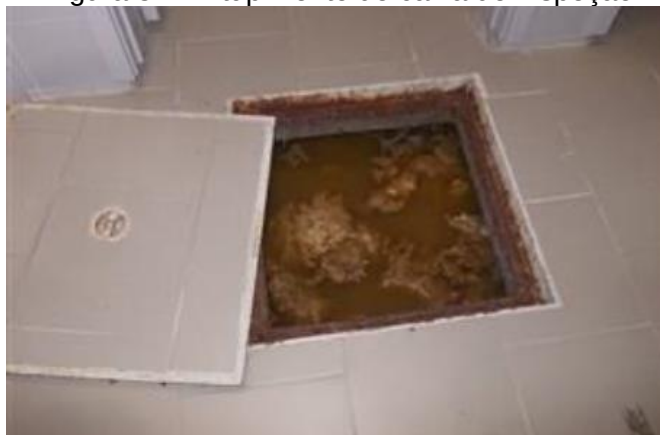
Figura 32: Entupimento de caixa de inspeção
