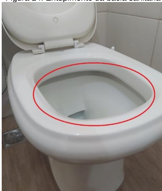
Figura 24: Entupimento da bacia sanitária
