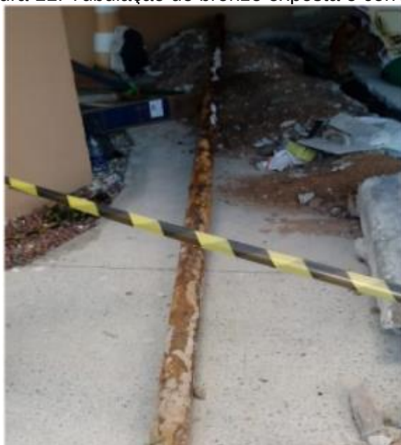
Figura 11: Tubulação de bronze exposta e corroída
