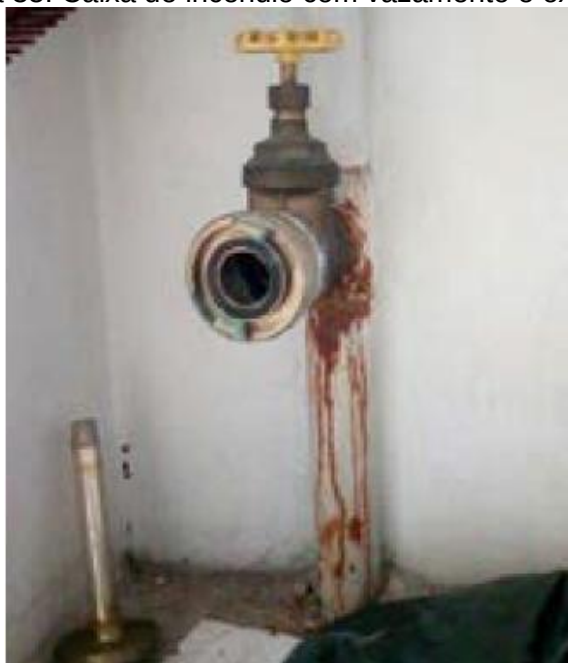
Figura 35: Caixa de incêndio com vazamento e oxidação
