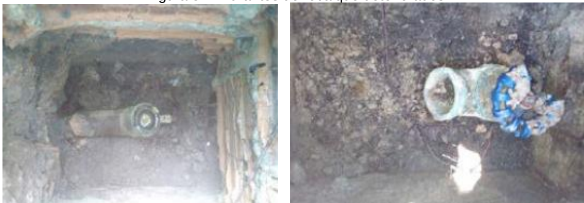
Figura 37: Hidrantes de recalque deteriorados
