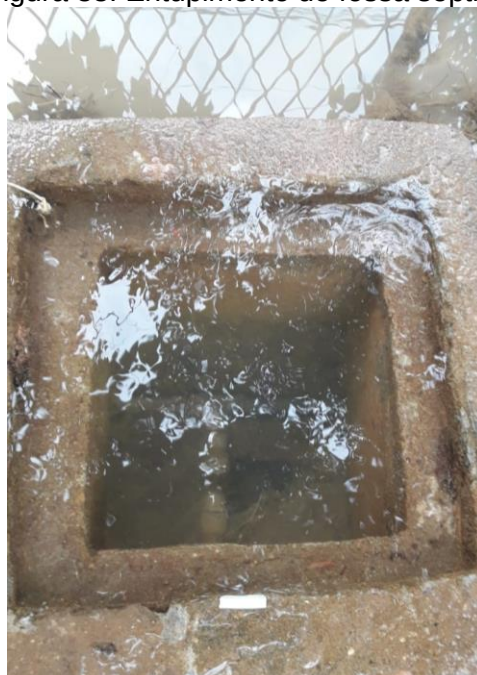
Figura 33: Entupimento de fossa séptica
