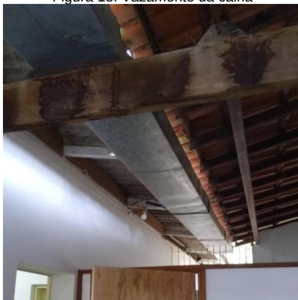
Figura 18: Vazamento da calha
