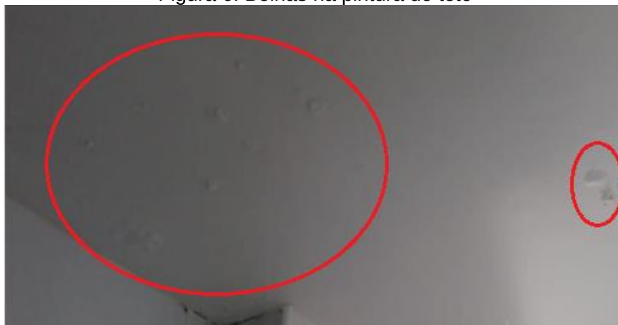
Figura 6: Bolhas na pintura do teto
