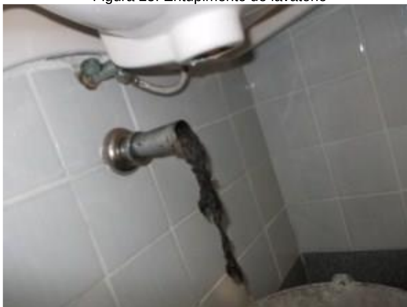
Figura 25: Entupimento de lavatório
