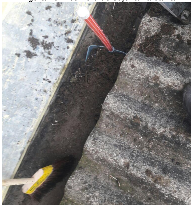
Figura 20: Acúmulo de sujeira na calha
