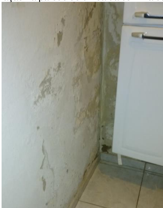
Figura 9: Infiltração na parede de divisa da cozinha com a despensa
