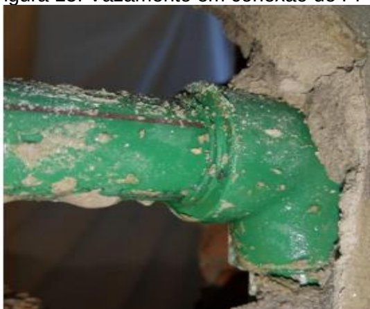
Figura 15: Vazamento em conexão de PPR
