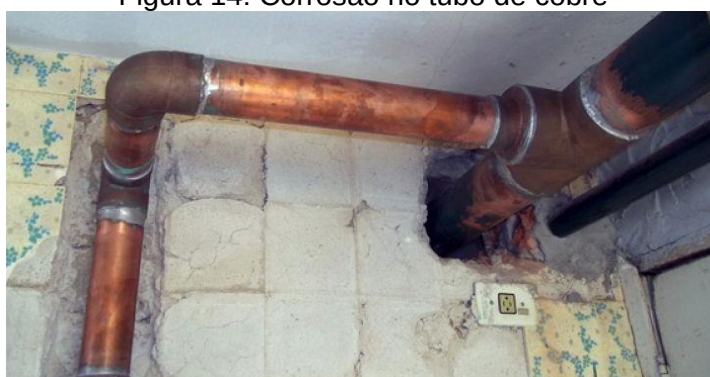
Figura 14: Corrosão no tubo de cobre
