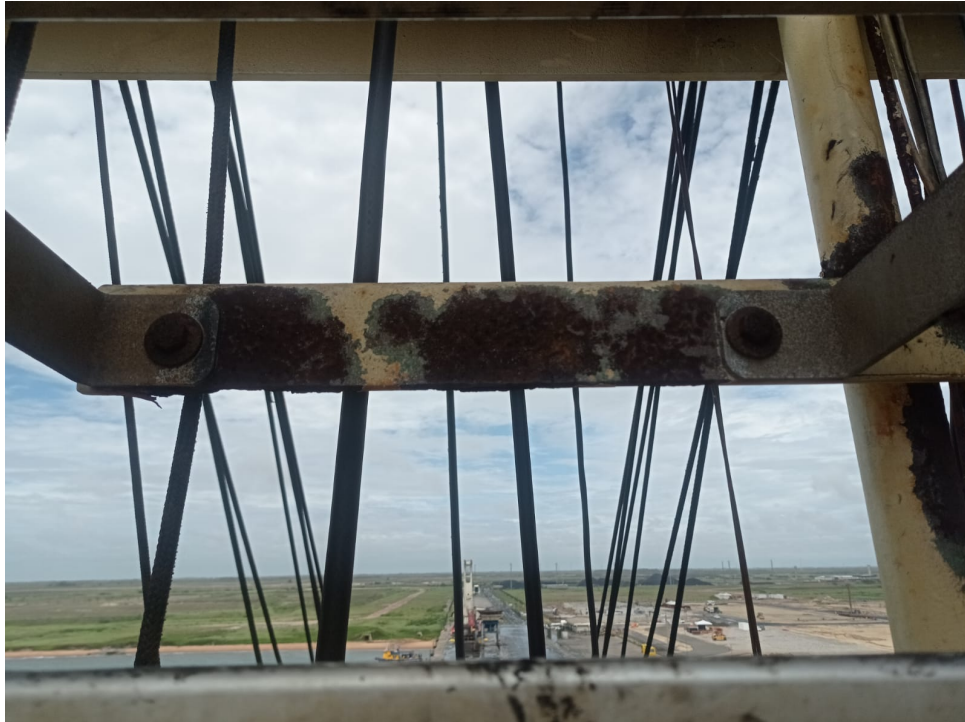
Figura 03: Corrosão por pites, chassi MHC 01
