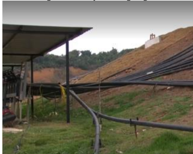
Figura 7: Estação de regulação
