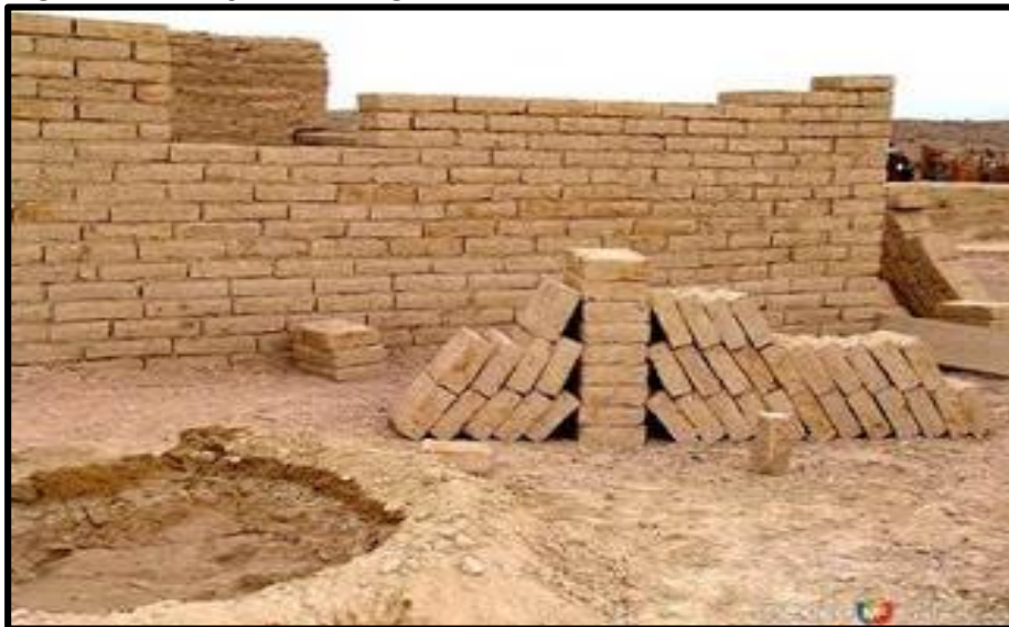
Figura 01 – Tijolo de argila secado ao sol
