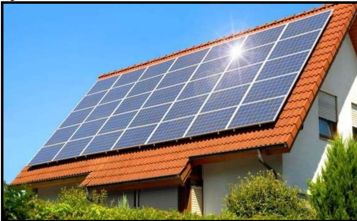
Figura 78: Painéis solar em residência.
