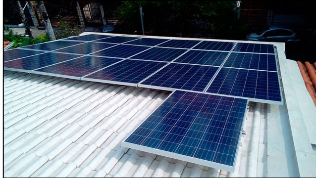
Figura 85: Placa solar fotovoltaica.
