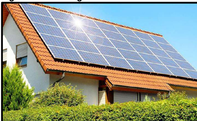
Figura 130– Energia solar fotovoltaica
