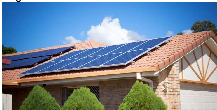
Figura - Placas Fotovoltaicas
