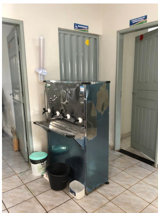
Figura 3: Falta de acessibilidade da UBS
