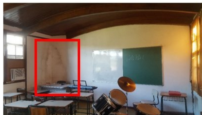
Patologia identificada na sala de bateria.
