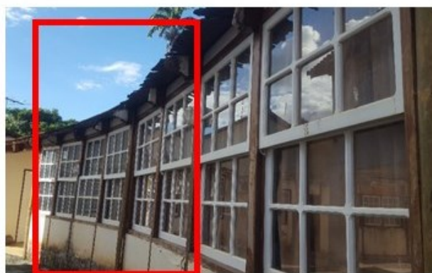
Patologias e danos ao telhado.
