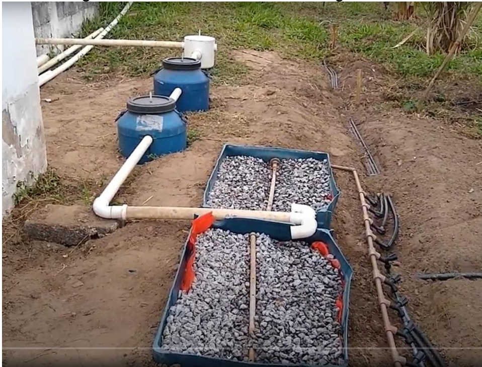
Figura 68: Sistema de tratamento de águas cinzas
