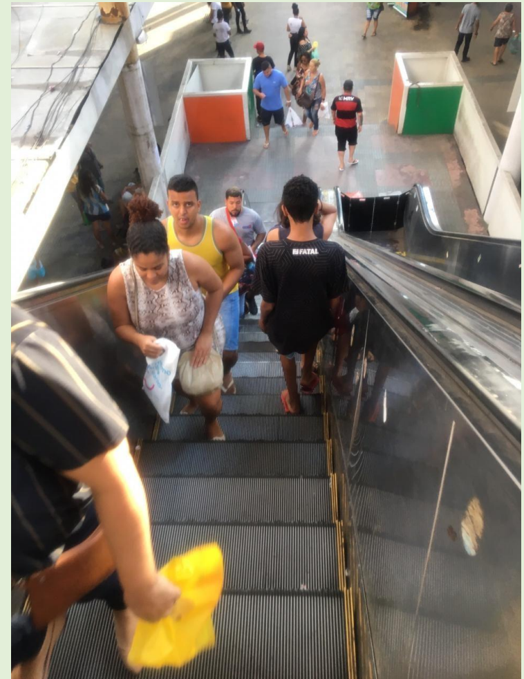
Figura04. Com uma das escadas rolantes parada, a que está em uso é dividida para os dois sentidos.
