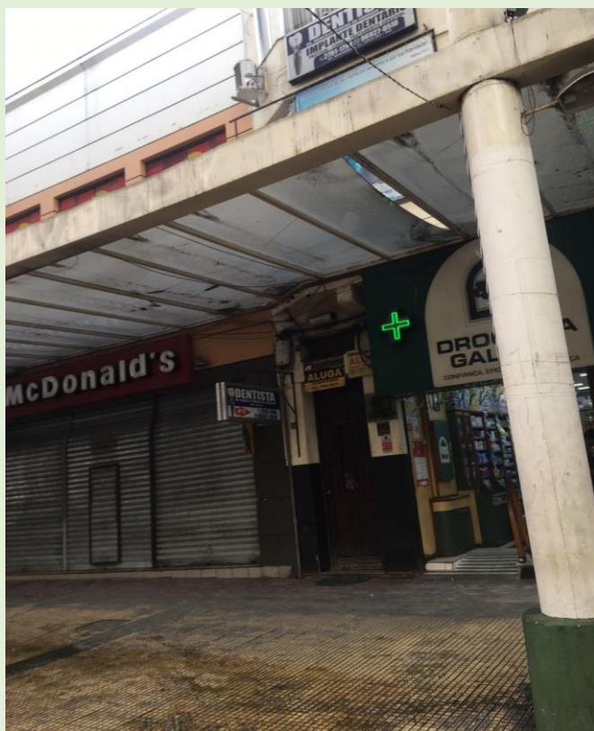
Figura 20. Parte da cobertura que cedeu
