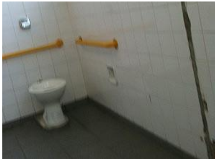
Banheiro da escola estadual Buenos Aires, zona norte de São Paulo, após queda de porta e divisória.
