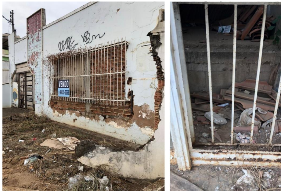
Fotografia 2 – Lote ocioso em ruínas e sujidades
