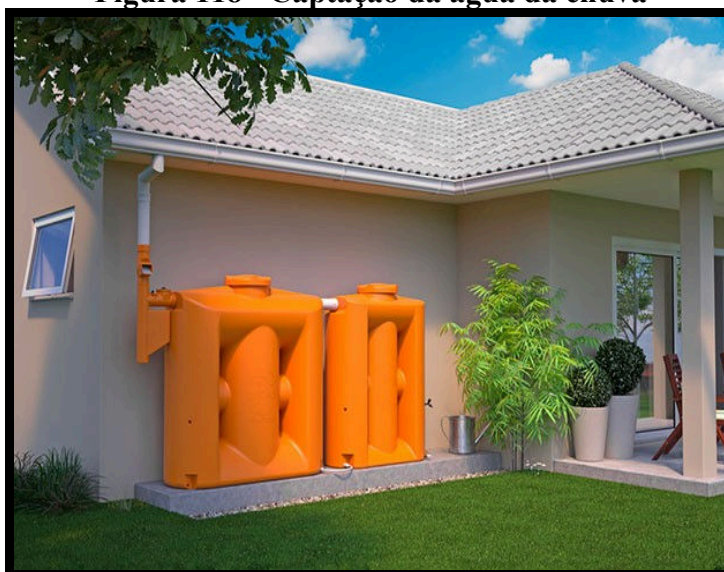
Figura 118 - Captação da água da chuva
