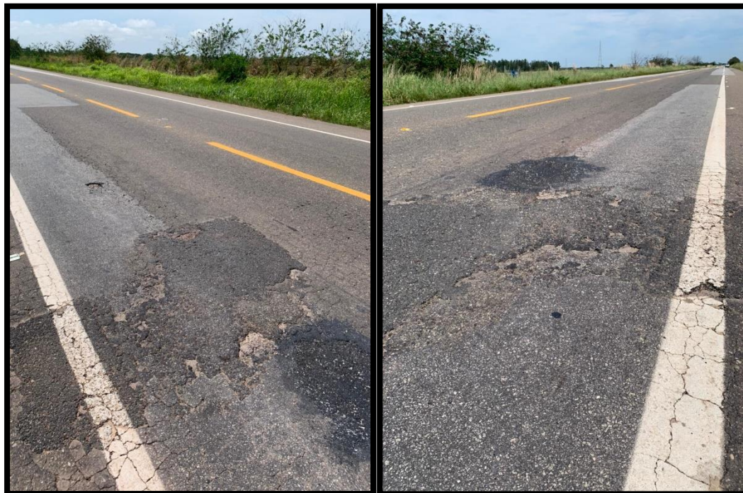
Figura 21: Patologia Deterioração Remendo
