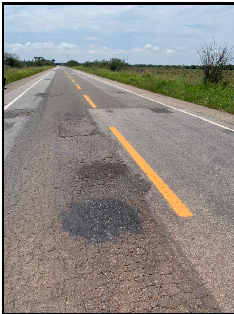
Figura 17: Patologia Trinca de Couro de Jacaré.
