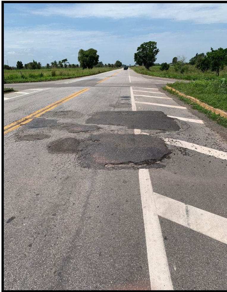
Figura 34: Patologia Deterioração de Remendo.
