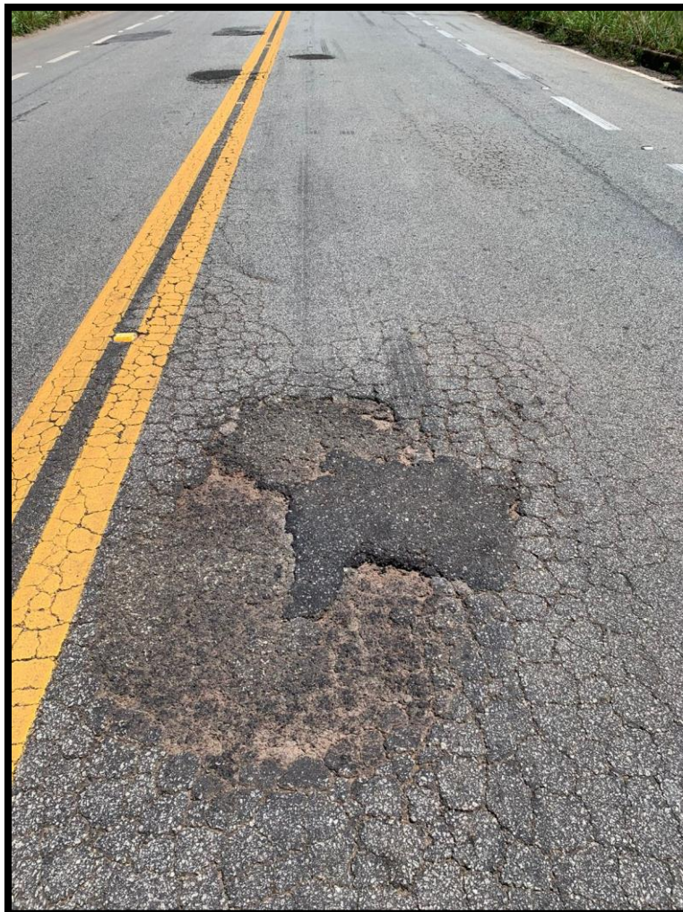
Figura 36: Patologia Trinca de couro de jacaré e Desgaste.
