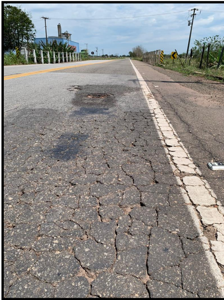
Figura 27: Patologia Trinca de Couro de Jacaré e Deterioração de remendos
