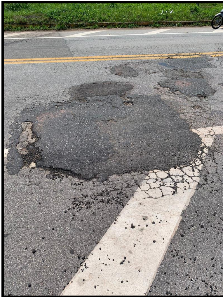
Figura 35: Patologia Deterioração de Remendo tampando a Trinca de couro de jacaré.
