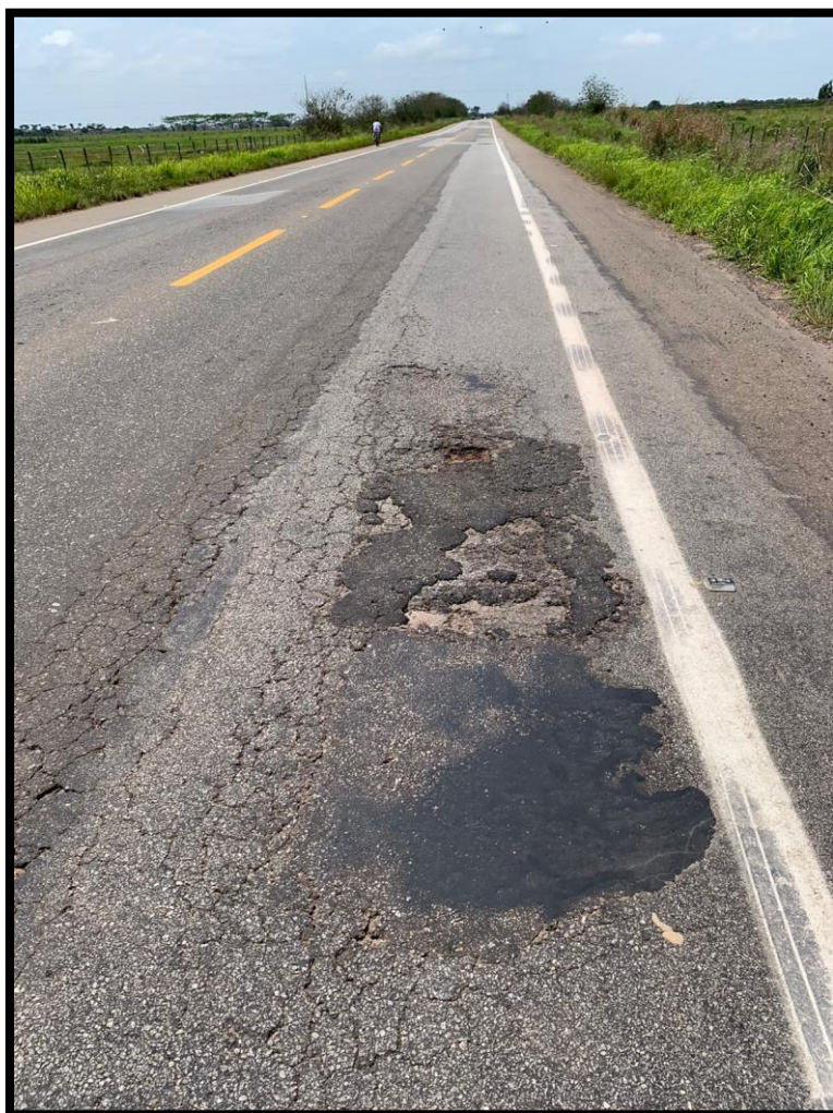
Figura 24: Patologia Afundamento de Consolidação e Trinca de couro de jacaré e deterioração de remendo.
