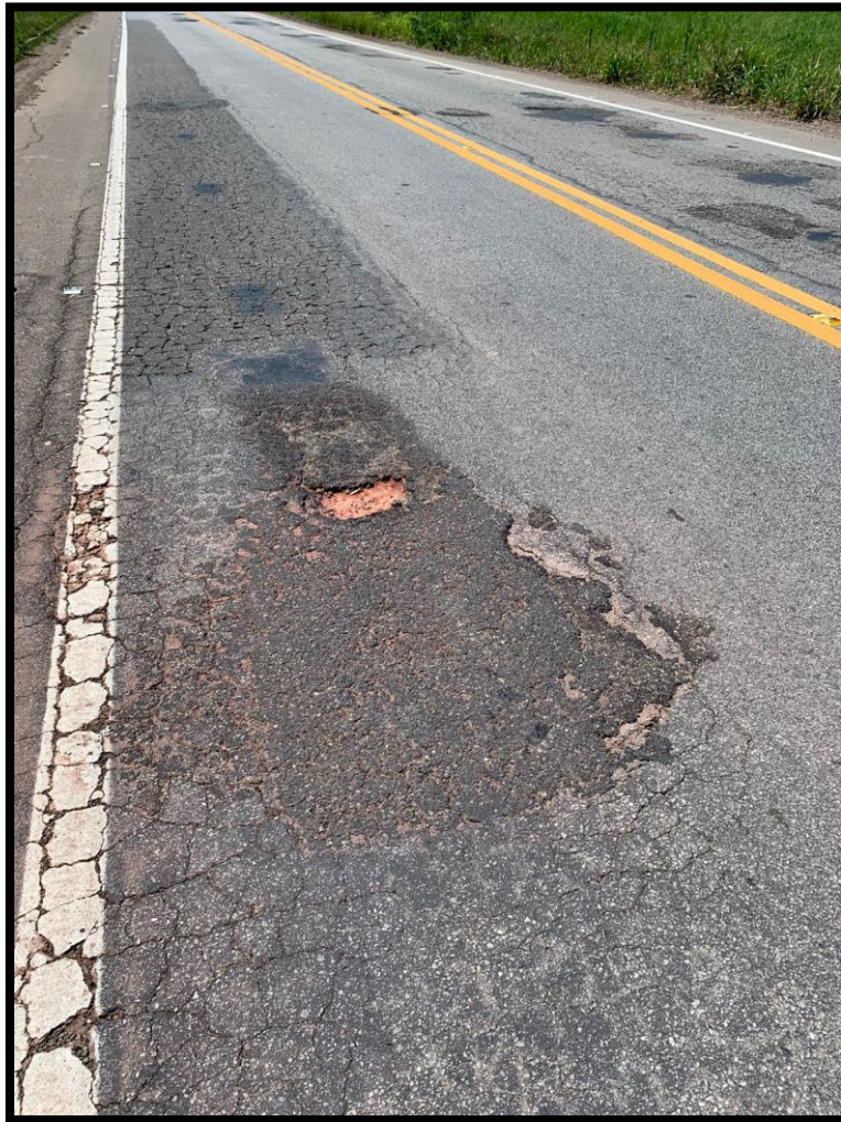
Figura 28: Patologia Deterioração de Remendo, Panela e Trinca de couro de jacaré.
