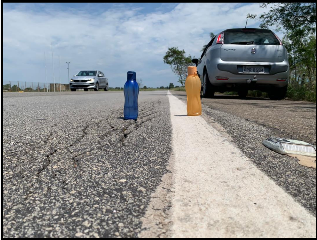
Figura 29: Patologia Afundamento de Consolidação
