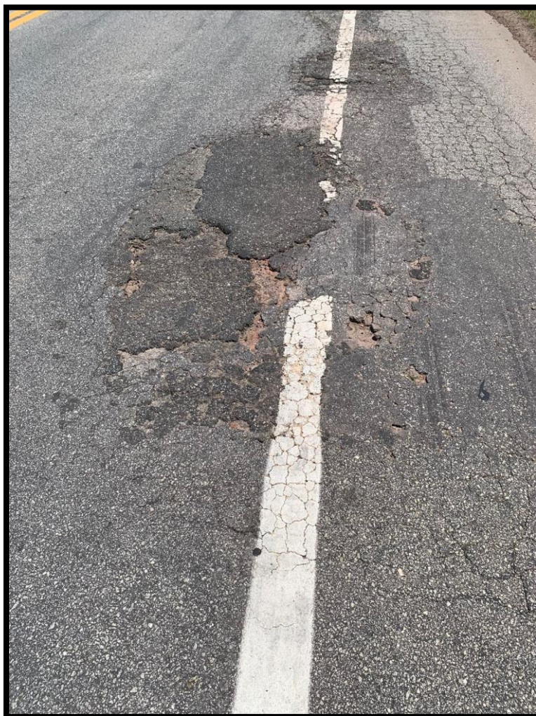
Figura 31: Patologia Deterioração de remendos
