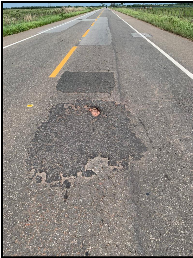
Figura 22: Patologia Deterioração de Remendo e Panela
