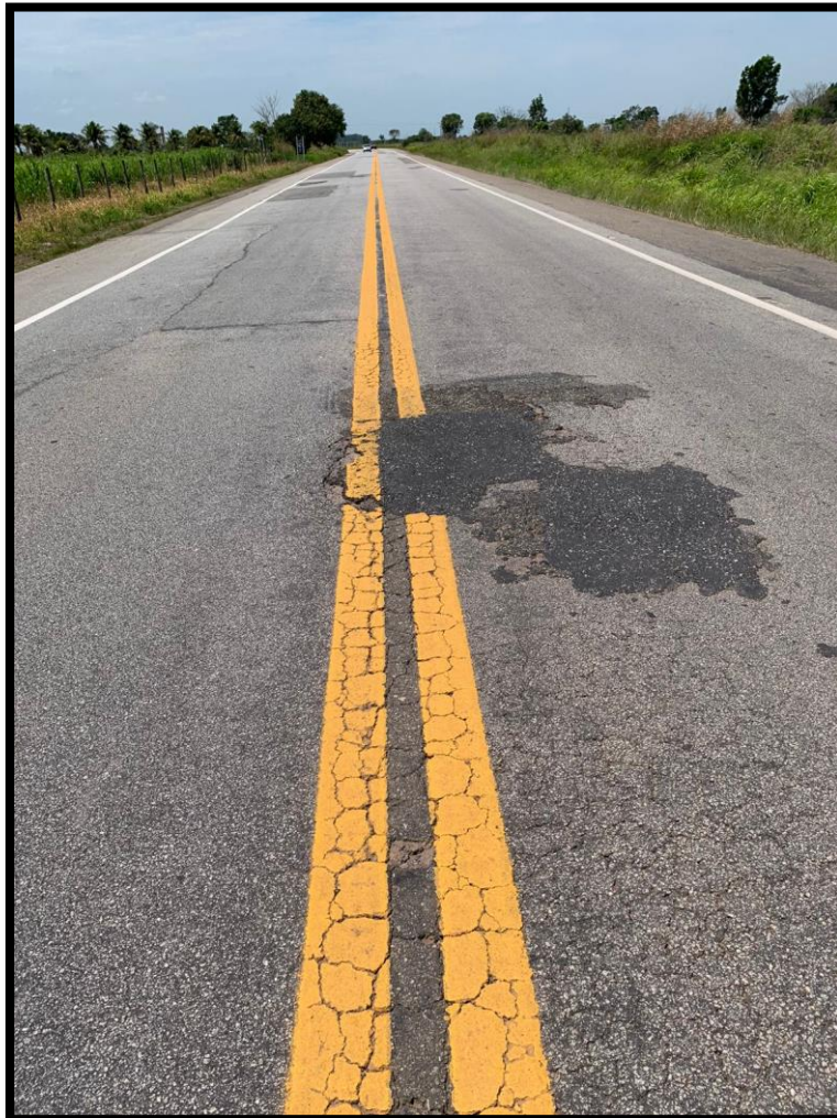
Figura 30: Patologia Trinca de couro de jacaré.
