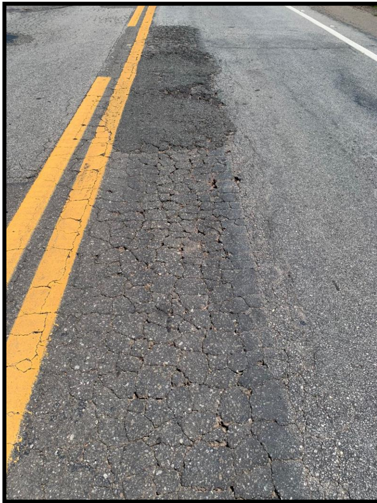
Figura 26: Patologia Trinca de Couro de Jacaré
