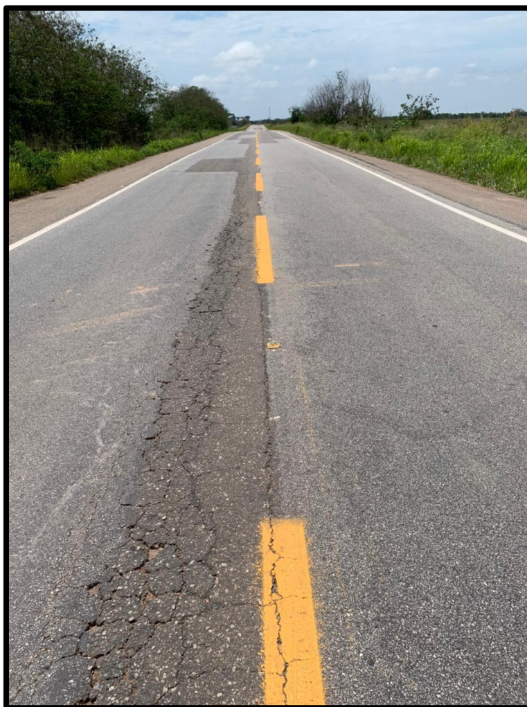
Figura 18: Patologia Afundamento de Consolidação.
