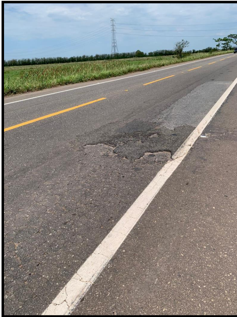
Figura 25: Patologia Deterioração de Remendo.
