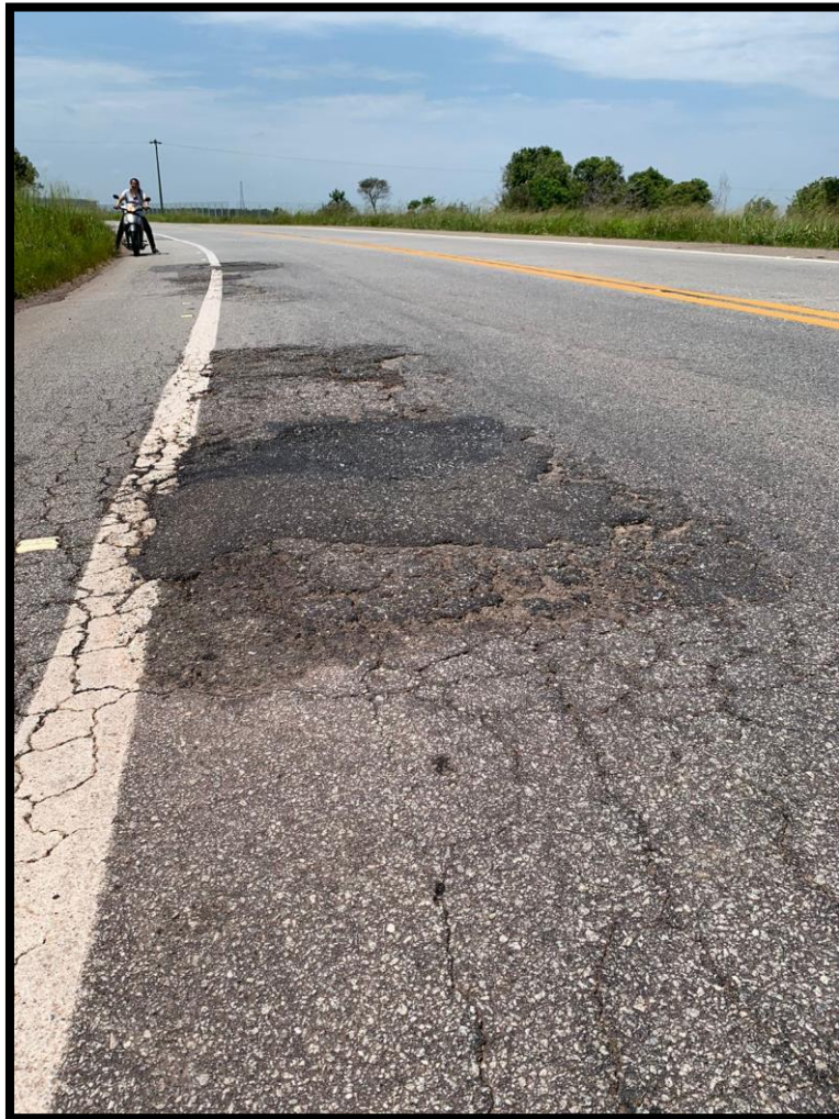
Figura 32: Patologia Deterioração de remendos
