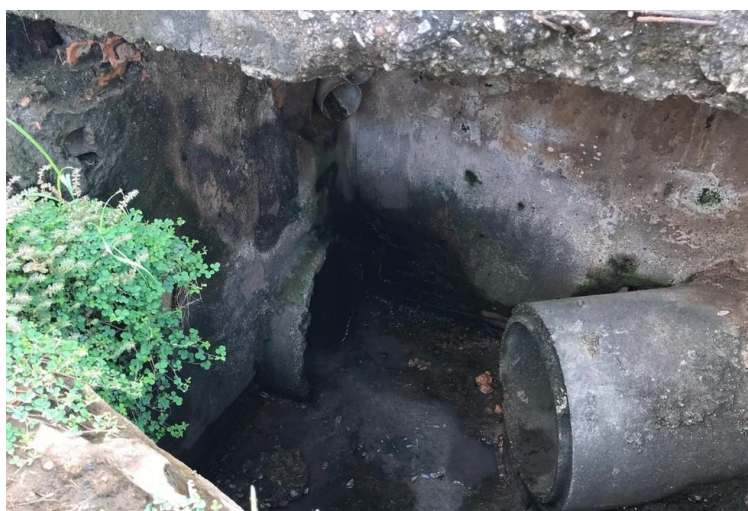
Figura 4 - Esgoto aberto na região central de Porto Velho
