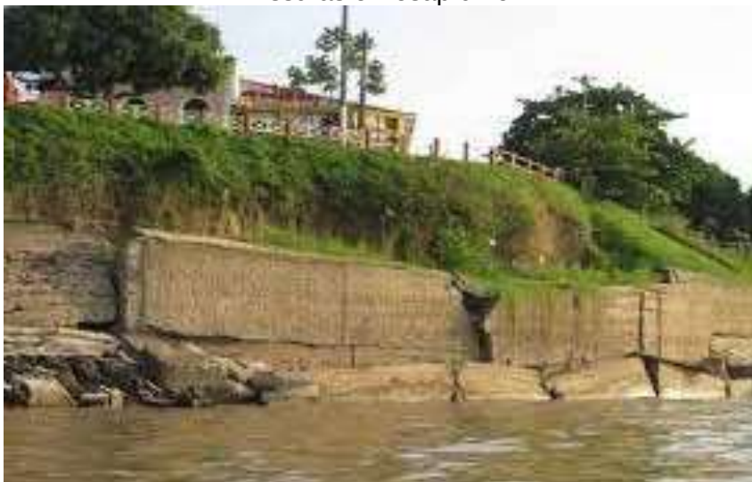
Figura 21: Muro de Concreto Armado Colapsando Devido a Inúmeras Patologias, como Fissuras e Desaprumo.
