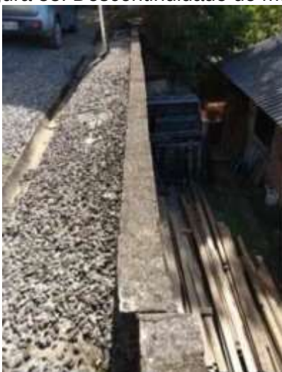
Figura 38: Descontinuidade do muro.
