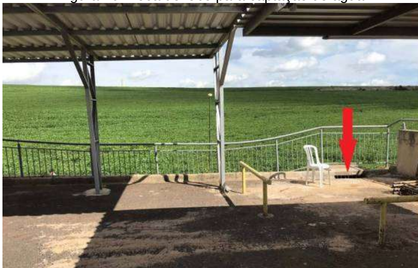
Figura 40: Boca de lobo para captação de água.
