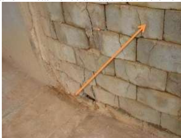
Figura 18: Trincas Devido à Instabilidade Muro-Fundação.
