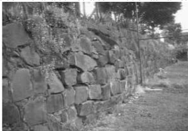
Figura 17: Contenção de Alvenaria de Pedra com Problemas na Estabilização dos blocos.
