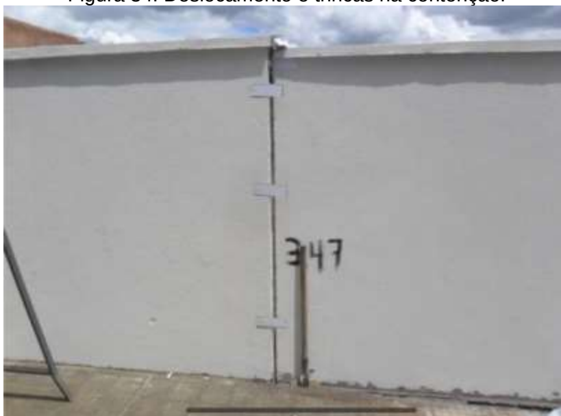
Figura 34: Deslocamento e trincas na contenção.
