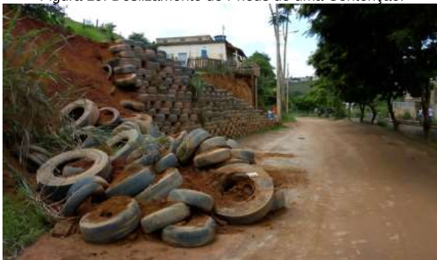
Figura 19: Deslizamento de Pneus de uma Contenção.
