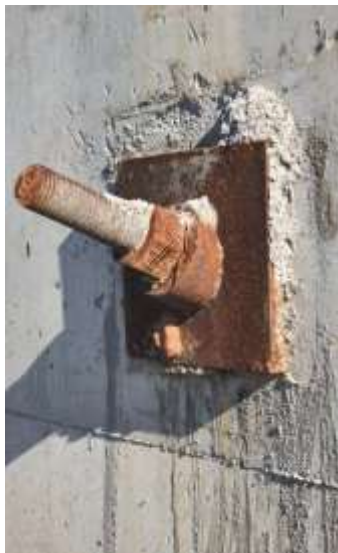
Figura 24: Porca Tracionadora do Tirante Sofrendo Processo de Corrosão.
