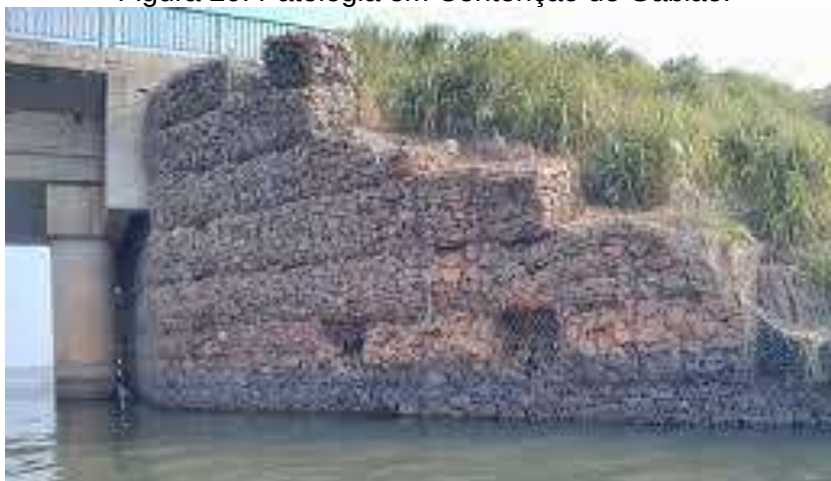
Figura 20: Patologia em Contenção de Gabião.
