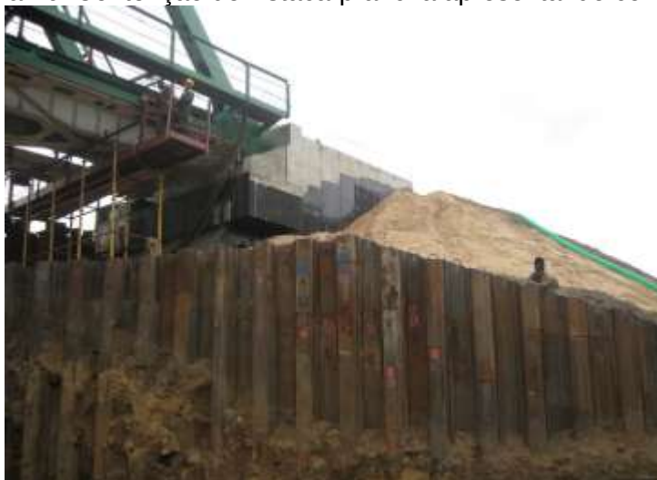
Figura 26: Contenção de Estaca-prancha apresentando corrosão.
