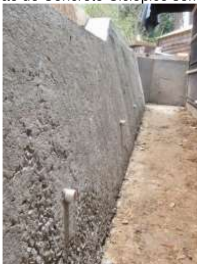
Figura 5: Contenção de Concreto Ciclóptico sem blocos evidentes.
