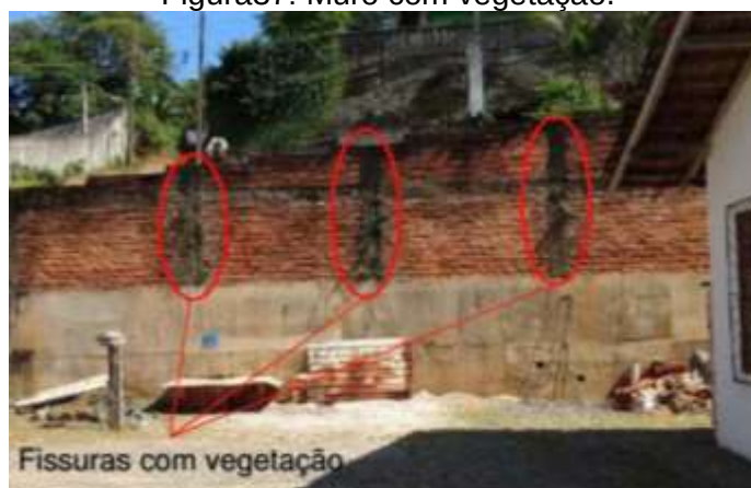
Figura37: Muro com vegetação.
