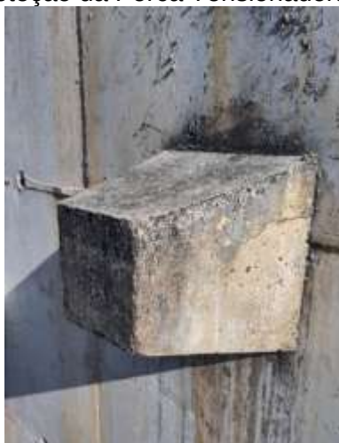
Figura 25: Proteção da Porca Tensionadora dos Tirantes.
