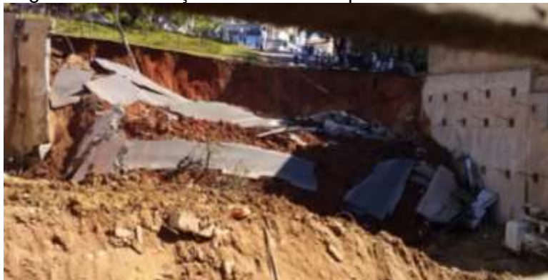
Figura 23: Contenção de Solo Grampeado Desmoronada.
