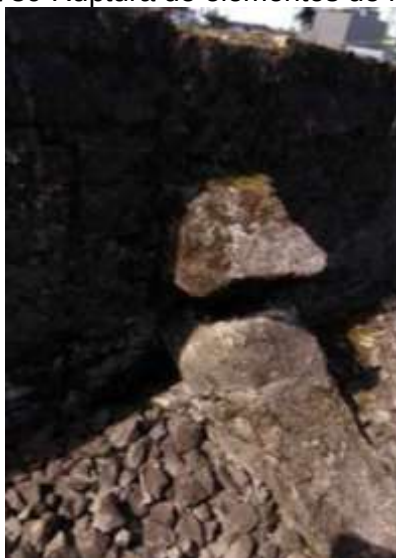
Figura 39 Ruptura de elementos de reforço.
