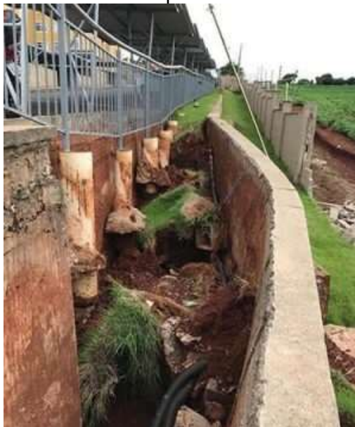
Figura 46: Buraco Criado por Carreamento de Material.
