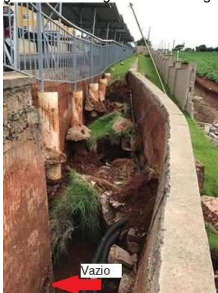
Figura 42: Patologia na concretagem.
