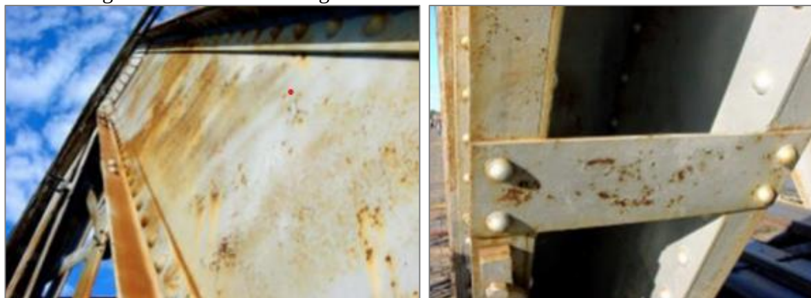
Figuras 05 e 06: Corrosão generalizada na Ponte Marechal Hermes – MG.
