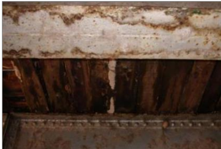
Figura 12: Apodrecimento da madeira do tabuleiro da Ponte sobre o Rio Atibaia no Distrito de Souza.
