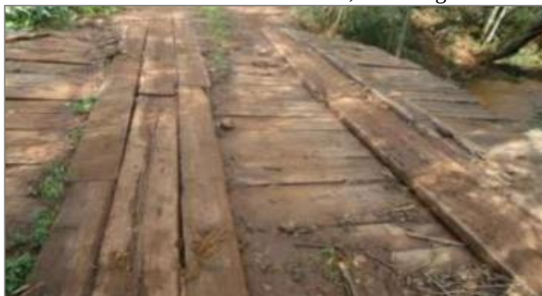
Figura 13: Ponte de madeira em Linha Barra Grande, com desgaste de abrasão mecânica.
