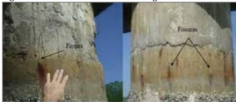
Figura 01: Fissura na Ponte sobre a Laguna de Roteiro - AL.
