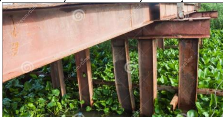
Figura 07: Deformação na estrutura de aço causada por sobrecarga.
