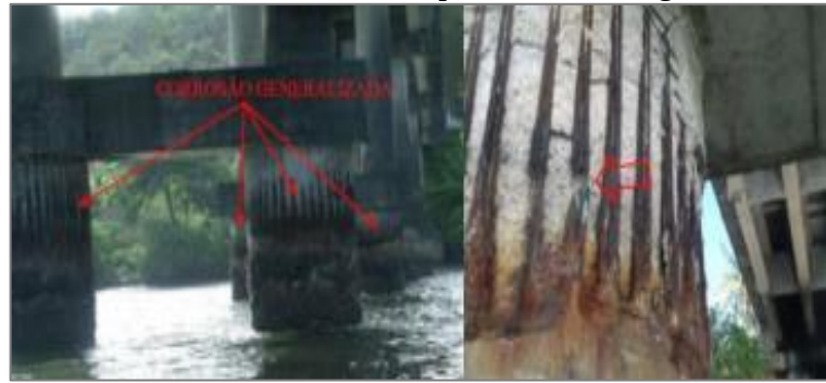
Figura 03: Corrosão nas armaduras da ponte sobre a laguna de Roteiro-AL.
