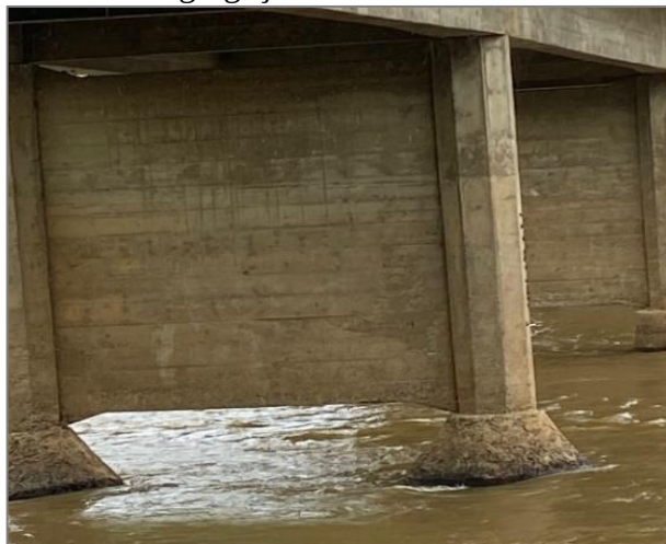
Figura 02: Desagregação de uma estrutura de concreto.
