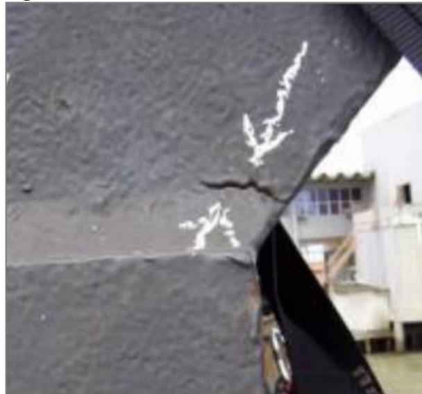
Figura 09: Fissuras na Ponte Hercílio Luz – SC.
