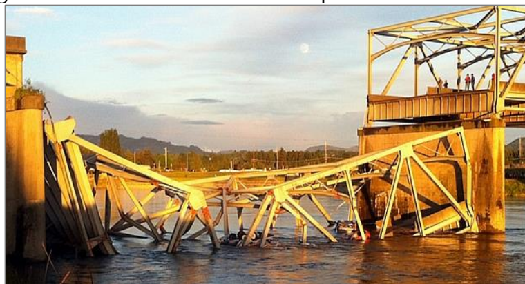
Figura 11: Colisão de caminhão numa ponte nos Estados Unidos.
