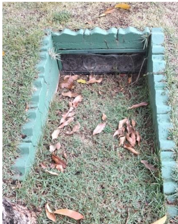
Figuras 16: Troca de ar e Saída de gases
