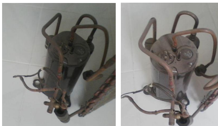
Fig 13: Compressor Principal Peça Danificada. Fonte: Empresa do Estudo (2015).
