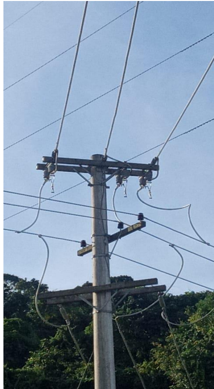
Figura 23 – Poste de concreto circular com 03 níveis de rede aérea convencional
