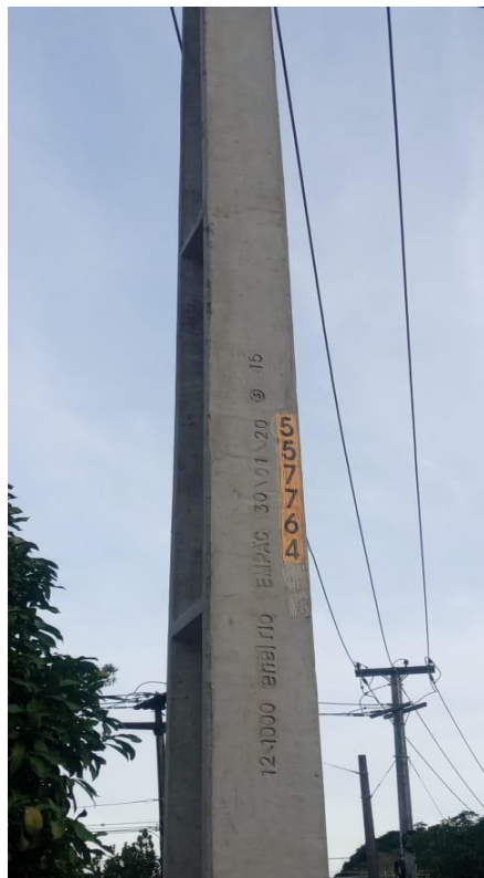
Figura 24 – Poste de concreto duplo “T” em rede aérea convencional com derivação
