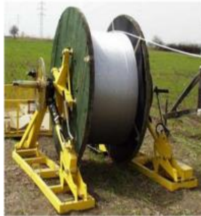
Figura 34 – Bobina elevada para a rede Elicord
