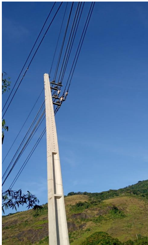
Figura 26 – Rede aérea compacta com dois alimentadores (02 níveis de rede)
