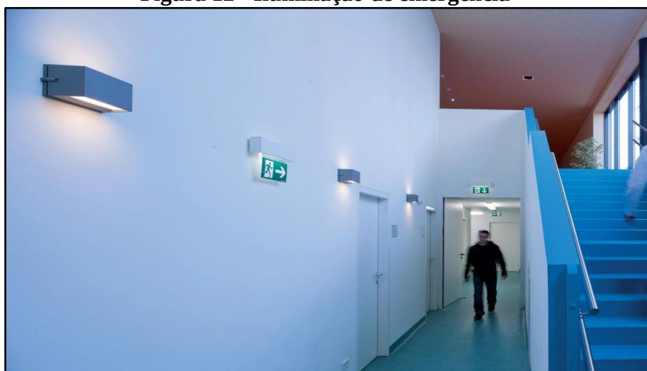
Figura 12 - Iluminação de emergência
