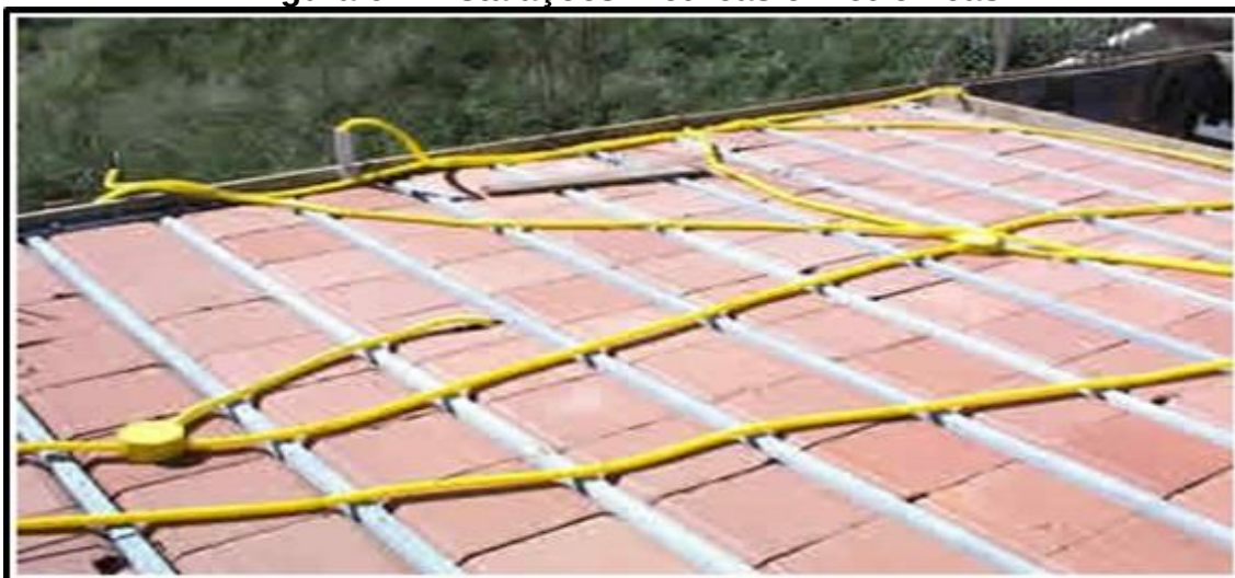
Figura 67: Instalações Elétricas e Eletrônicas
