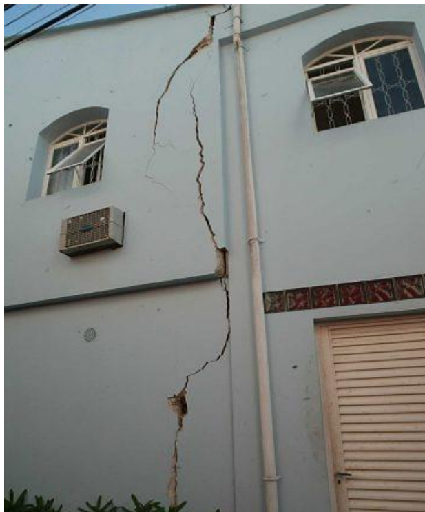
Figura 13: Casa com rachaduras.
