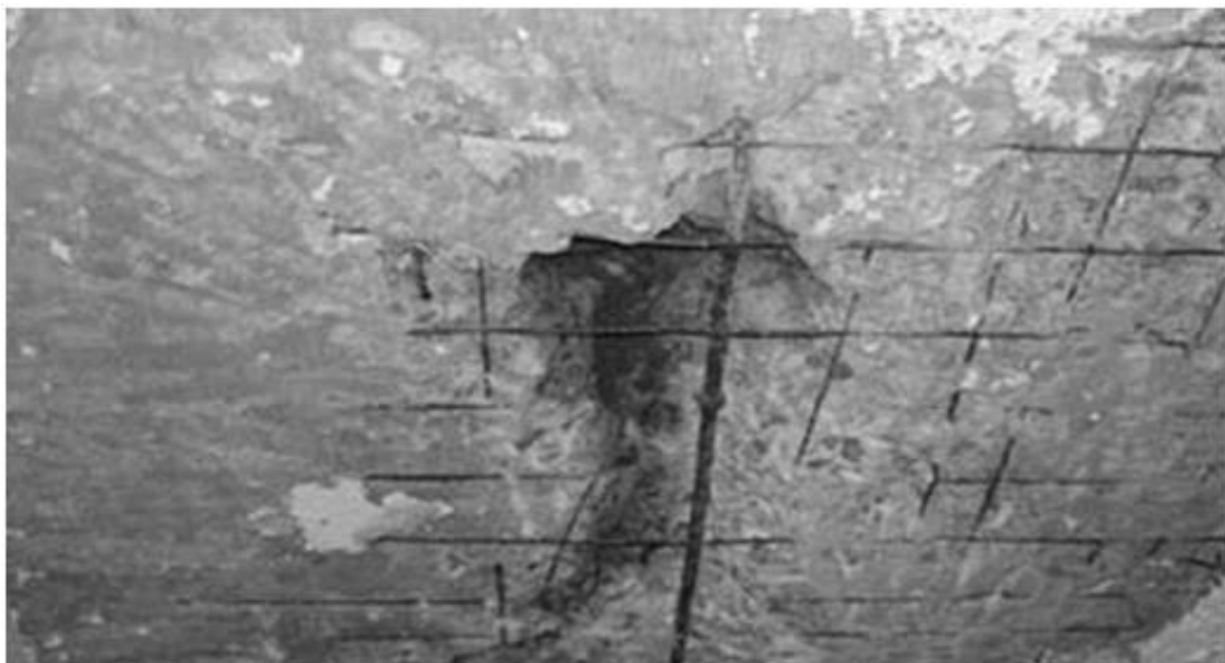
Figura 16: Desgaste do concreto
