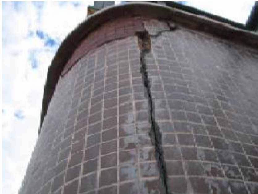
Figura 1: Patologia em Edificação
