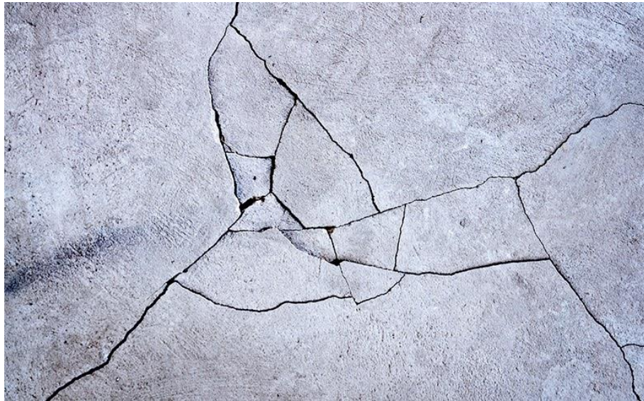
Figura 14: retração do concreto
