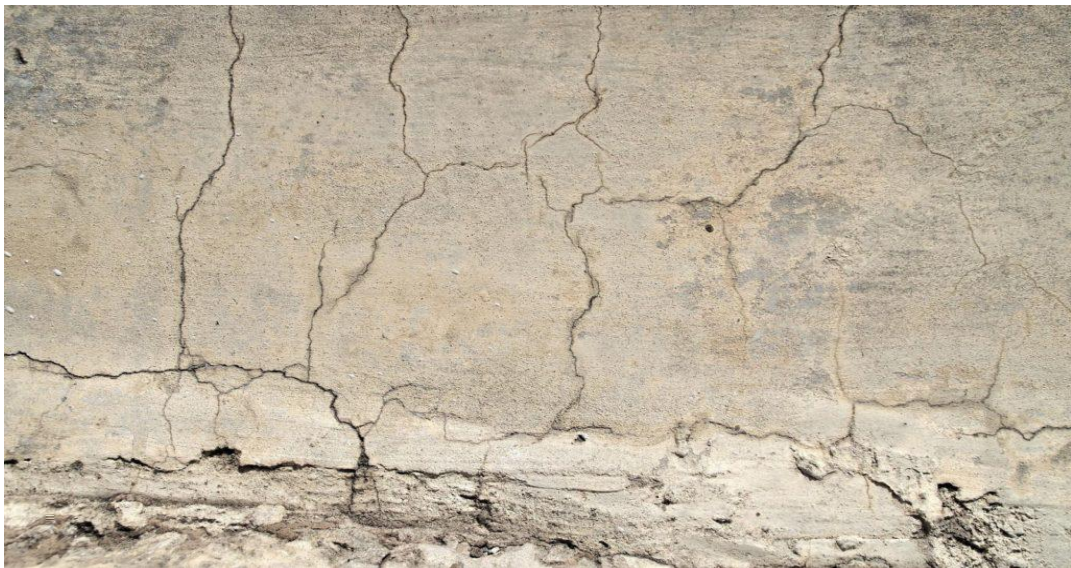
Figura 15: Retração do concreto
