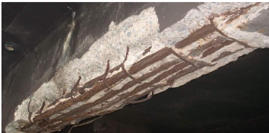
Figura 18: Corrosão em viga de concreto armado.
