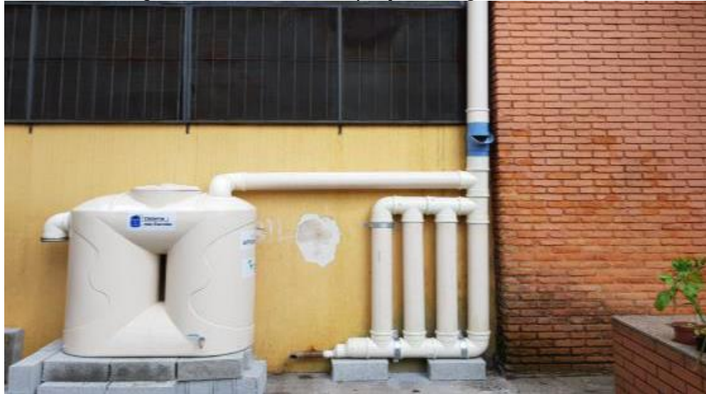
Figura 9 – Sistema de captação de água de chuva
