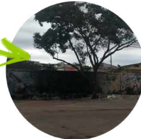
Figura 10 - Muro e Árvore Danificada.
