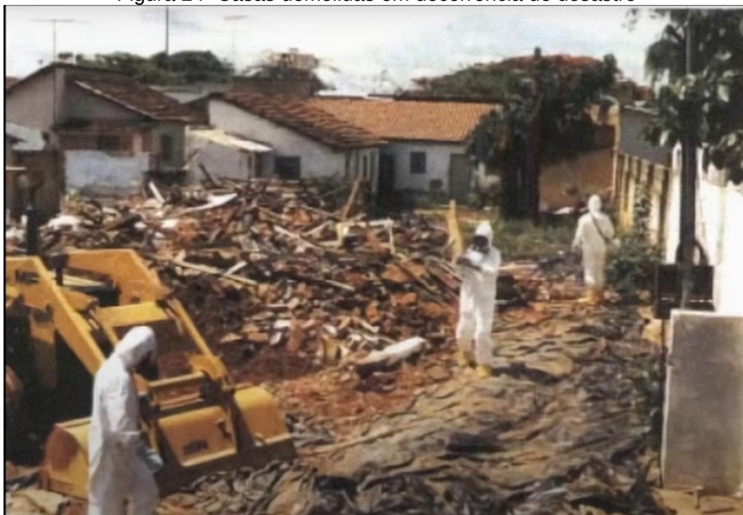
Figura 24- Casas demolidas em decorrência de desastre
