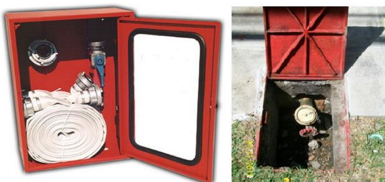
Figura 24 - Hidrante de parede e hidrante de recalque, respectivamente.
