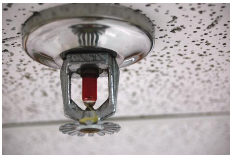
Figura 23 - Sprinkler ou chuveiro automático.
