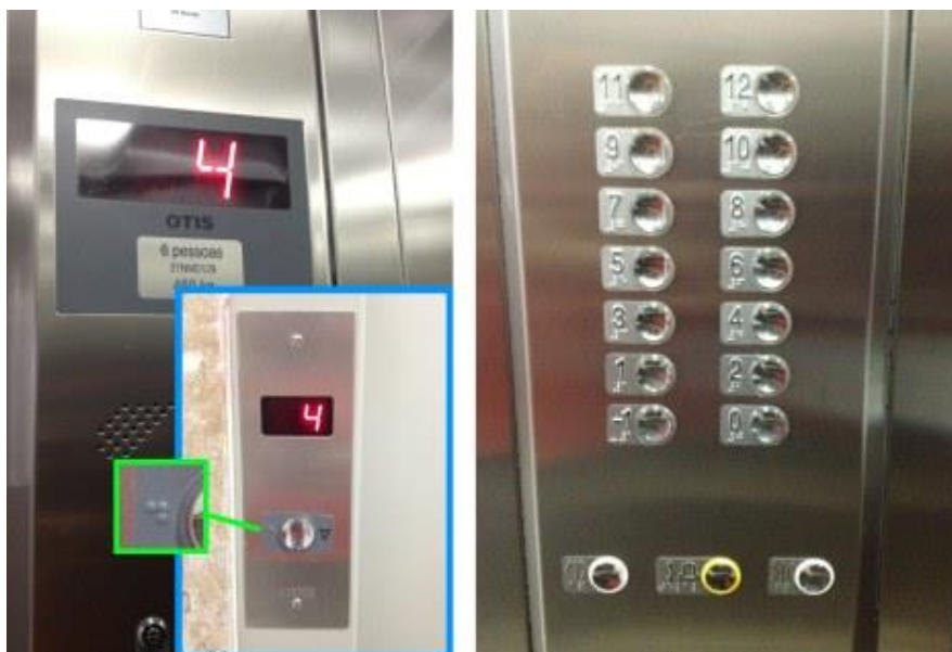
Figura 12: Painel de elevador e acessibilidade
