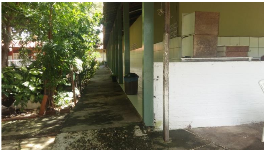
Figura 16 – Área sem guarda-corpo no bloco de quartos.
